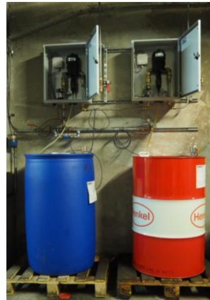
Abbildung 2: Die Mischstation sorgt für konstante Mischverhältnisse bei dem eingesetzten 2-Komponenten KSS von Henkel
