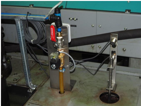
Abbildung 4: Der Schwimmerschalter rechts überwacht den Pegelstand des KSS im Tank. Das Ventil öffnet bei Bedarf und füllt immer Kleinmengen nach
